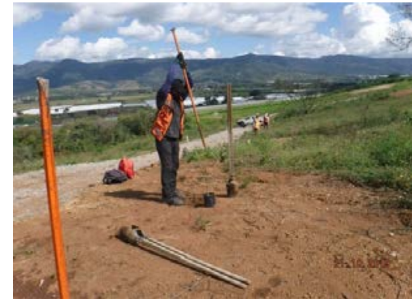
Figura 69 Ejemplo de apertura de cepa separando en dos la excavación (izquierda) y herramientas manuales empleadas para abrir cepas (derecha).
