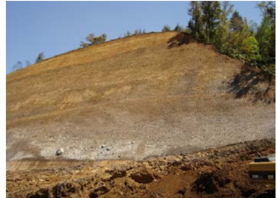
Figura 28 Ejemplo de estabilización de un corte revegetado con tulias. Autopista México-Tuxpan, tramo Tejocotal-Nuevo Necaxa.
